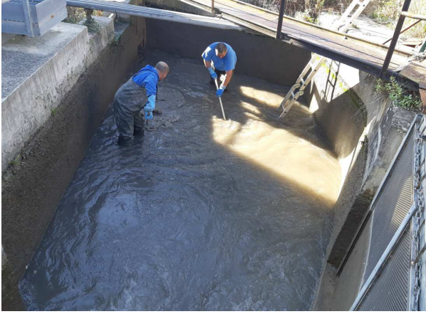
Nettoyage annuelle bêche « turbine » à Drouille- Manosque
