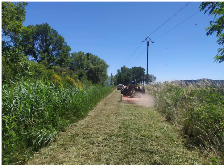
Opérations de débroussaillage mécanique (faucardage) ou manuel sur canal maître en secteurs difficiles d'accès et broyage à plat (en été) (ent. GERVASONI)
