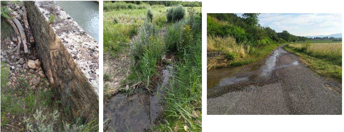
Désordres observés au niveau du canal maître et en contre-bas à proximité de la route départementale, de la voie ferrée et du chemin communal
