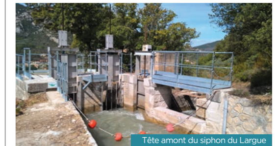
Tête amont du siphon du Largue
