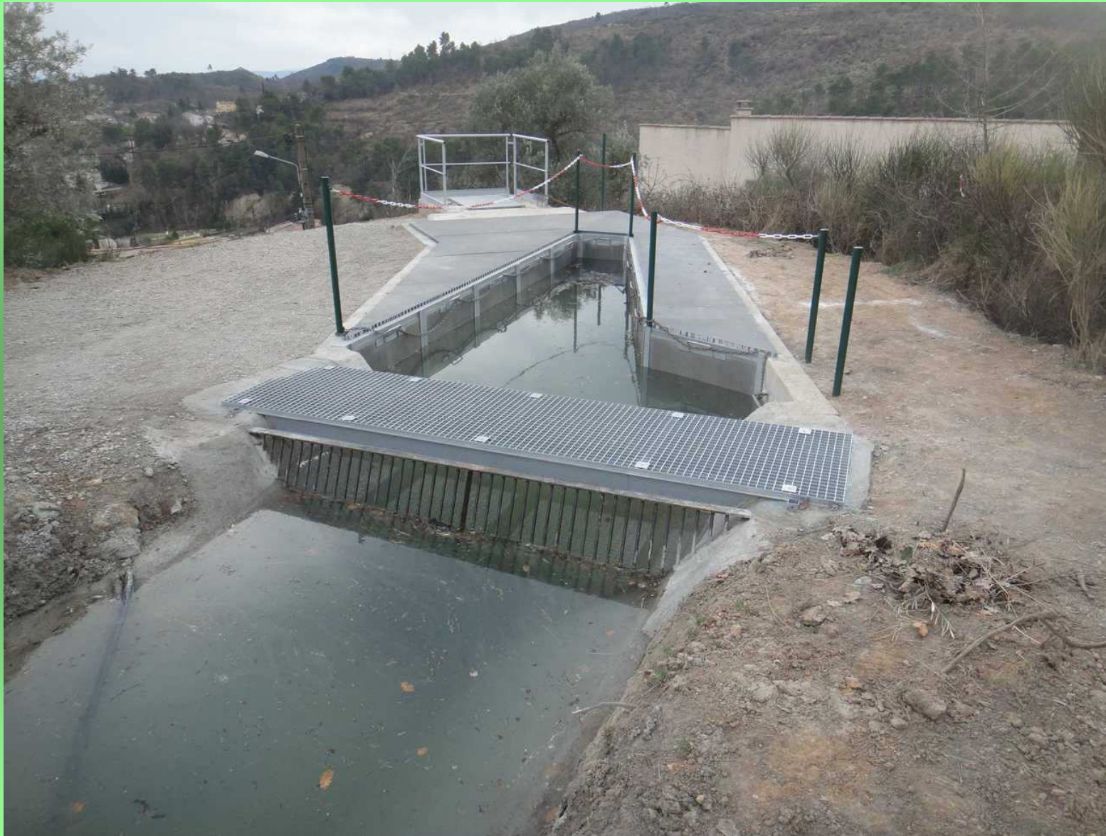
Dégrilleur manuel de tête de réseau, amont siphon Chaffère à Sainte Tulle
